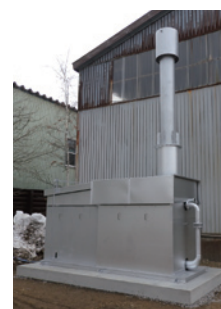
●残ガス燃焼装置
