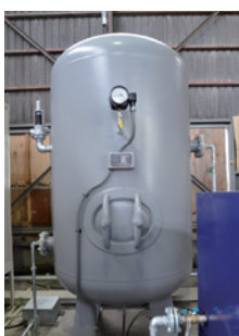
●バッファータンク
